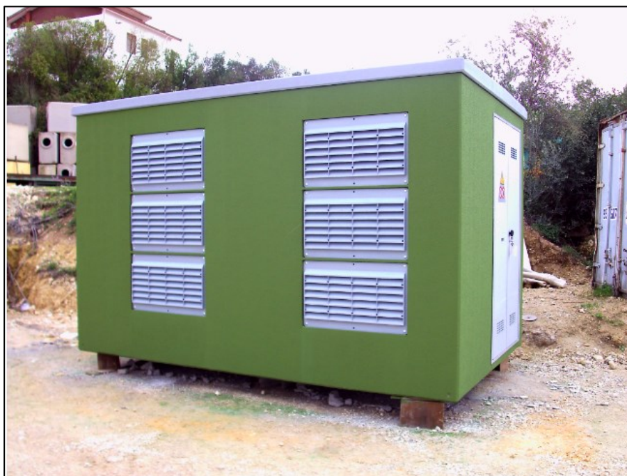
Tipico cabina elettrica prefabbricata
