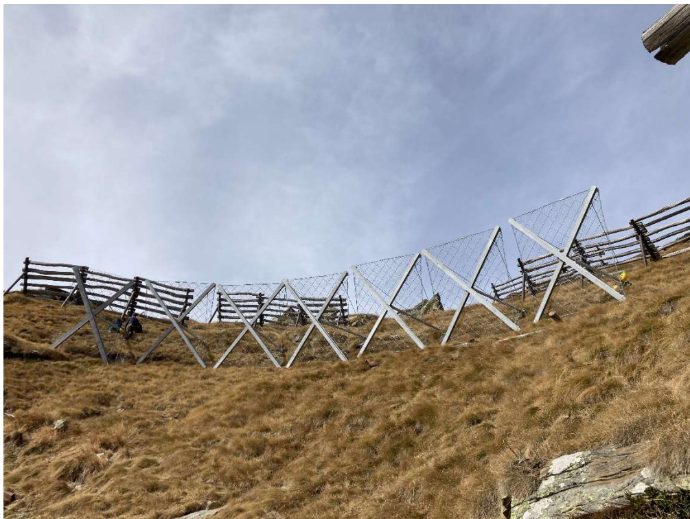
Foto 11.1 – Opere fermaneve monoancoraggio installate.
