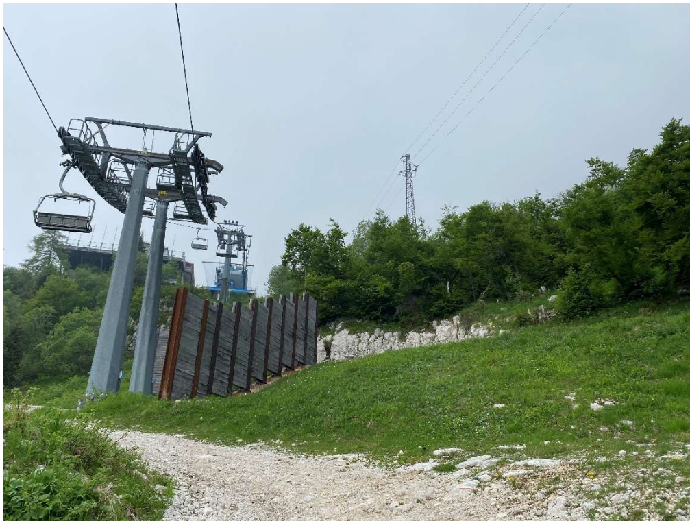
Foto 11.5 – Cuneo deviatore in carpenteria metallica e traverse di legname installato a protezione dei sostegni di un impianto di risalita.
