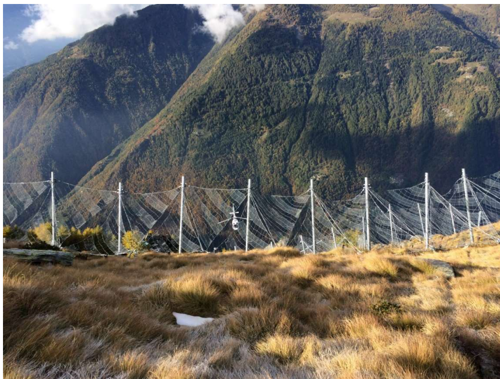
Foto 11.2 – Reti da neve installate.
