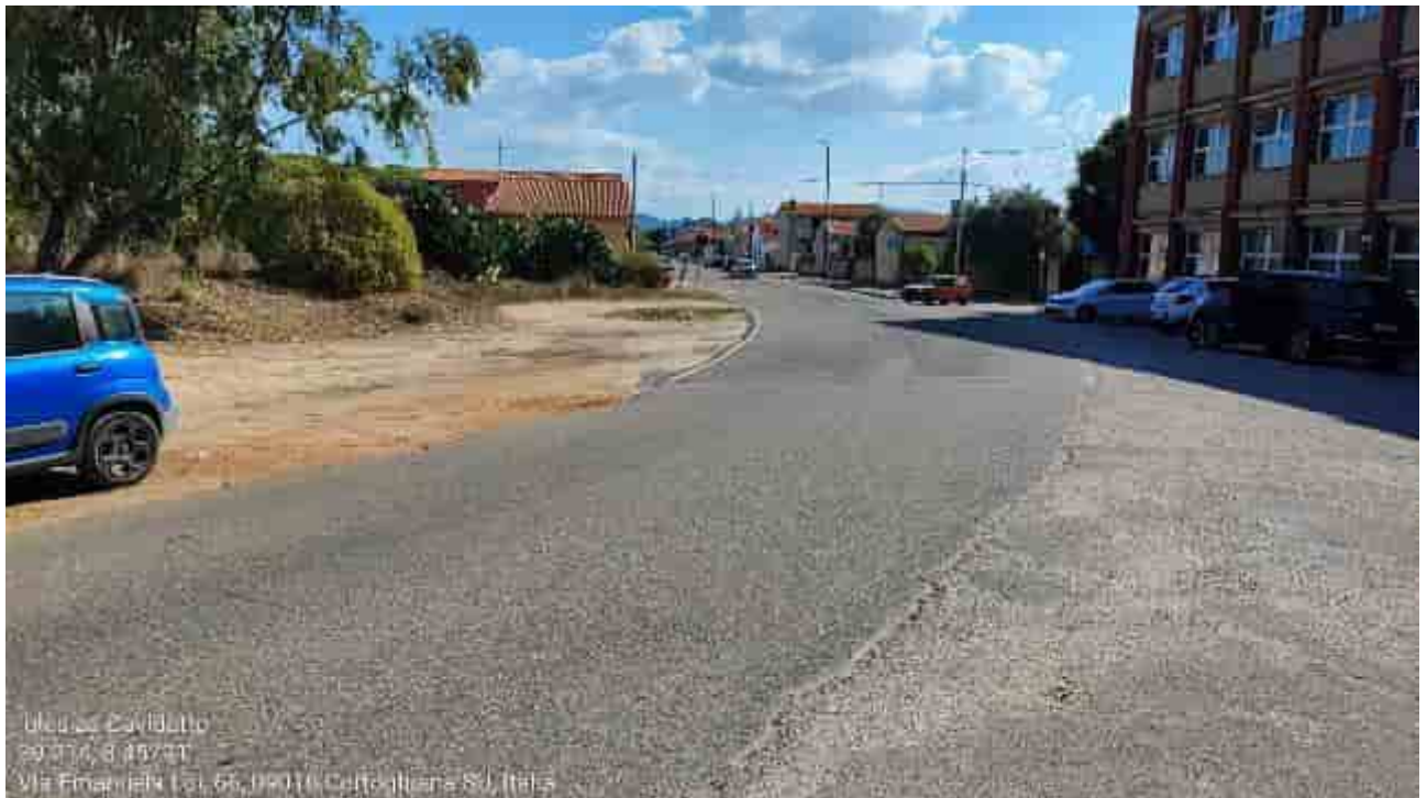
Carbonia, Cortoghiana: porzione di via Rinaldo Loi interessata dal tracciato del cavidotto.
