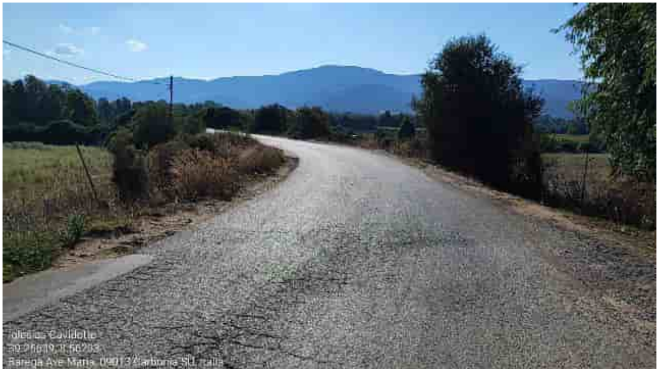
Carbonia, loc. Planu de Olionis: tratto stradale interessato dal tracciato in progetto.
