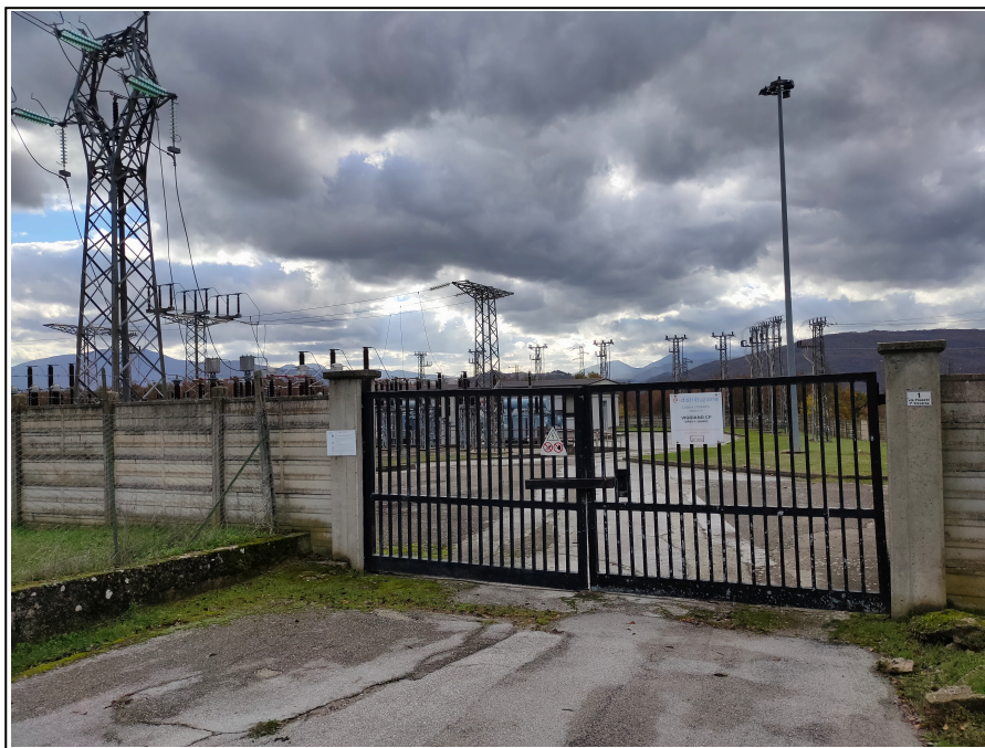
VISTA DEL TRATTO FINALE DI CONSEGNA ALLA CABINA PRIMARIA ENEL
