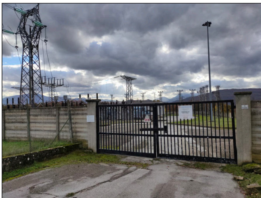
VISTA DEL TRATTO FINALE DI CONSEGNA ALLA CABINA PRIMARIA ENEL
