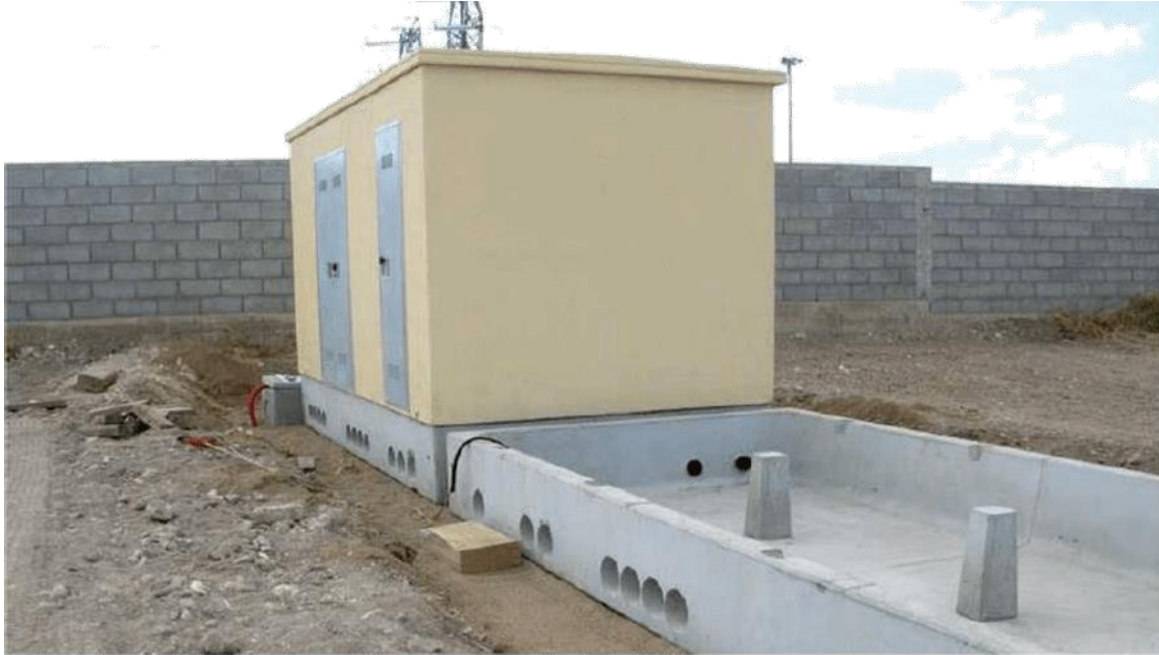
Figura 6.8: Foto esempio di cabina elettrica
