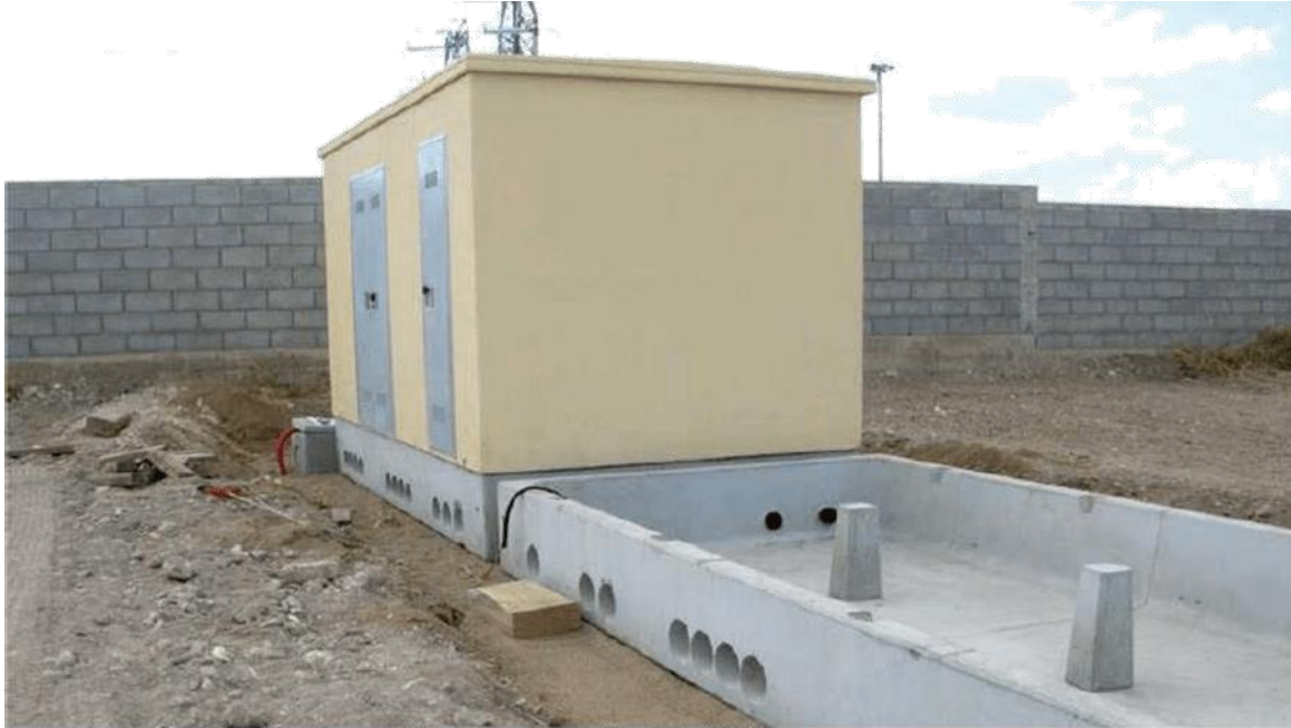
Figura 6.8: Foto esempio di cabina elettrica
