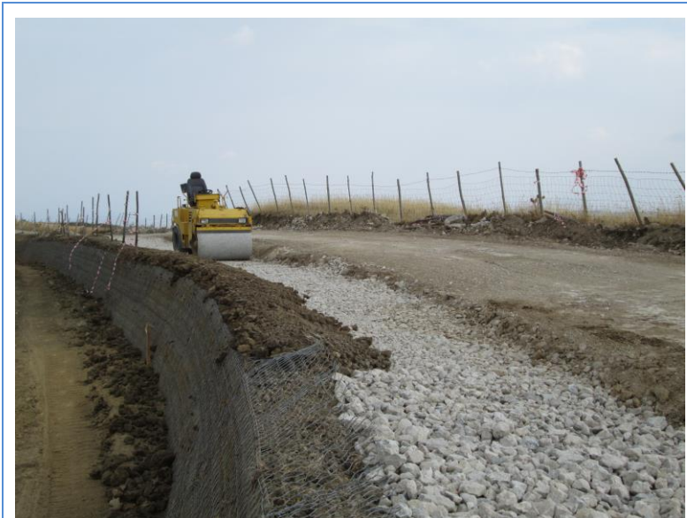
Figura 10 – Esempio di opera in terre rinforzate - Fonte HE
