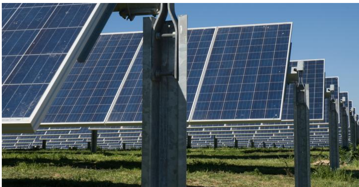
Figura 15 Immagine esplicativa dell'allestimento dei pannelli sulla struttura tracker
