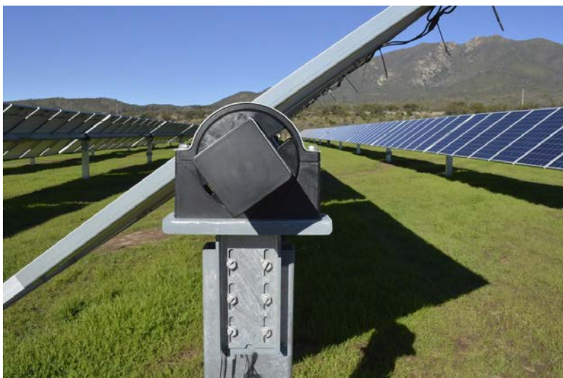
Figura 11 Dettaglio del tracker ad inseguimento
