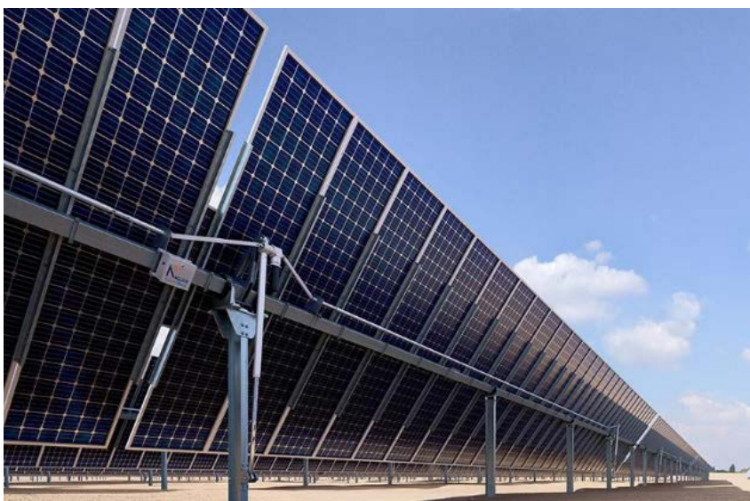
Figura 12 Dettaglio del tracker ad inseguimento
