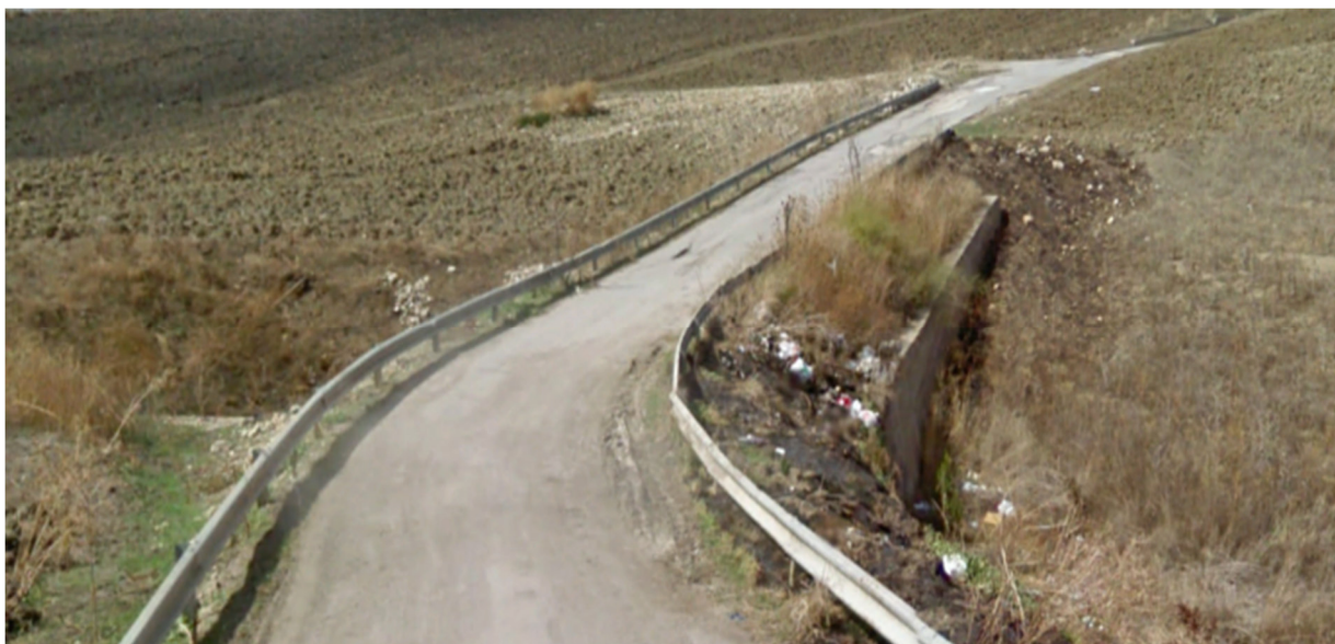
Interferenza 28 Attraversamento canale di scolo strada vic. Carbuscia Cataliello, Comune di Naro, e-distribuzione
