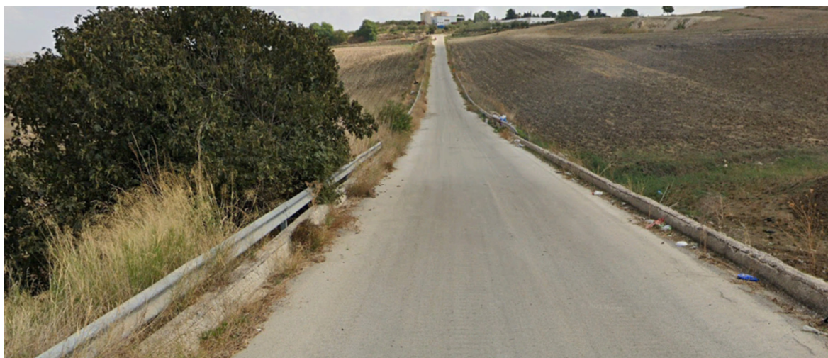
Interferenza 30 Attraversamento canale di scolo strada vic. Carbuscia Cataliello, Comune di Naro, e-distribuzione
