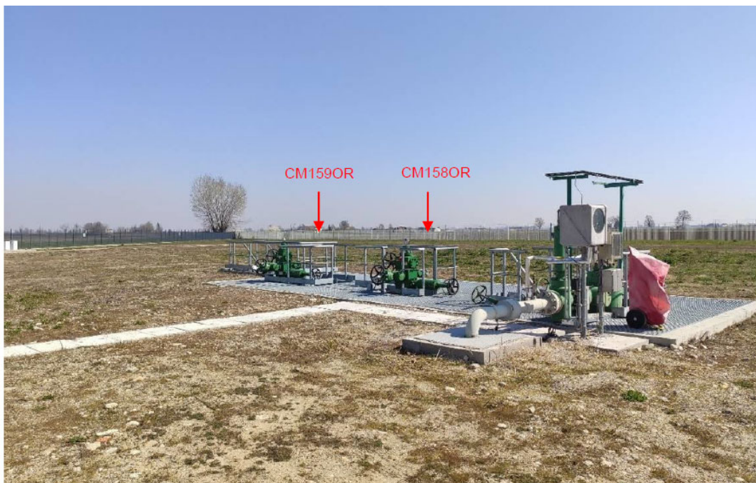
Figura 2.4: Vista da destra del pozzo CM156OR in esercizio e dei pozzi CM158OR/159OR da collegare
