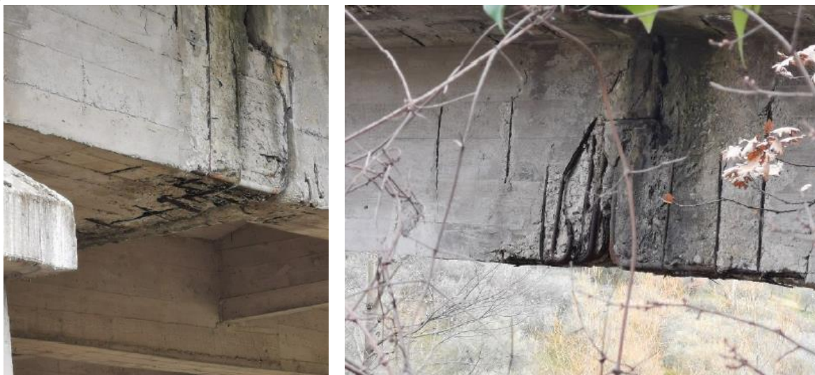
Figura 1: Presenza di lesioni sulle mensole Gerber
