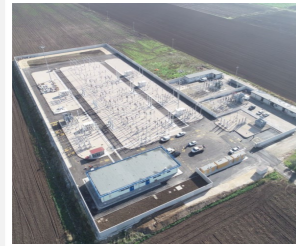
SE - STAZIONE ELETTRICA
