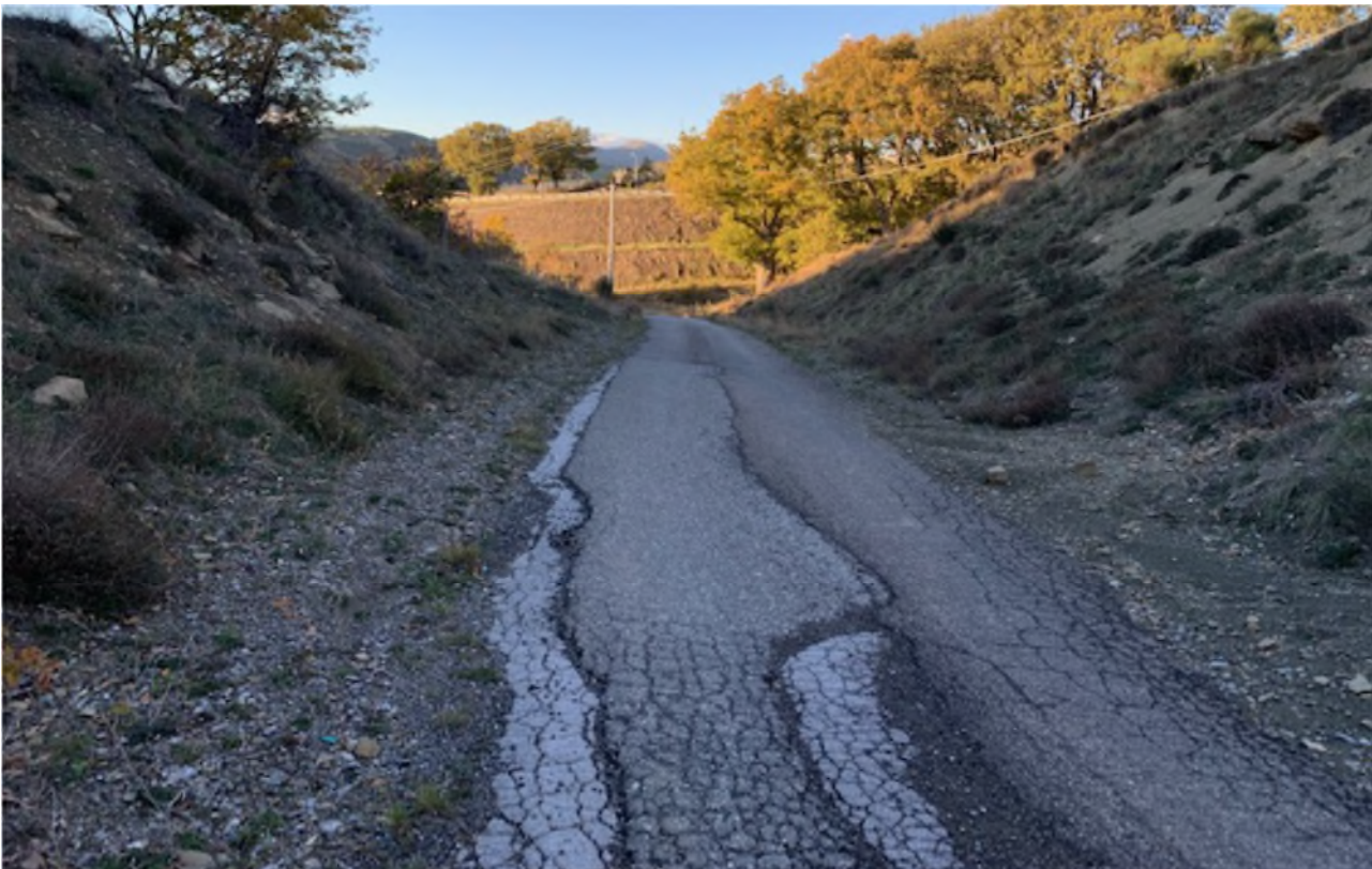
Fig. 4 Scarpata a pendenza elevata -fenomeni di dilavamento e caduta di materiale
