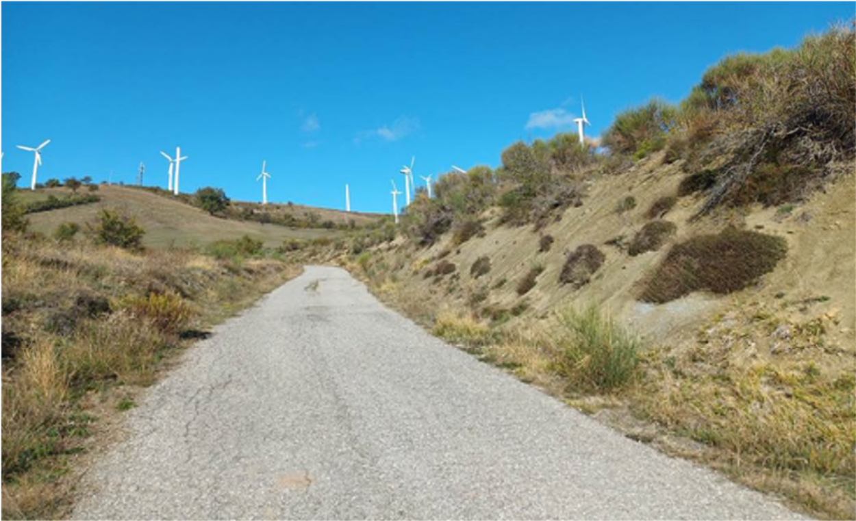
Fig 3 Assenza di cunette
