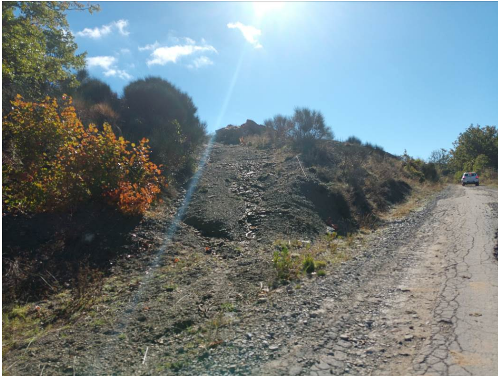
Foto 9 – Fenomeno di dilavamento superficiale
