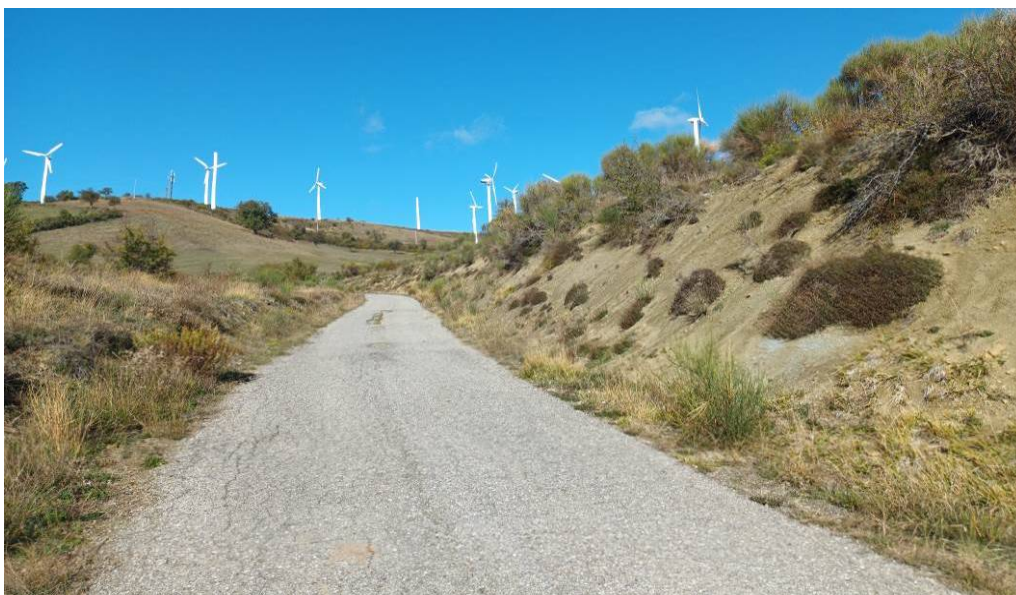
Foto n. 10 - Percorso flow line – scarpata con fenomeni di dilavamento e caduta di materiale
