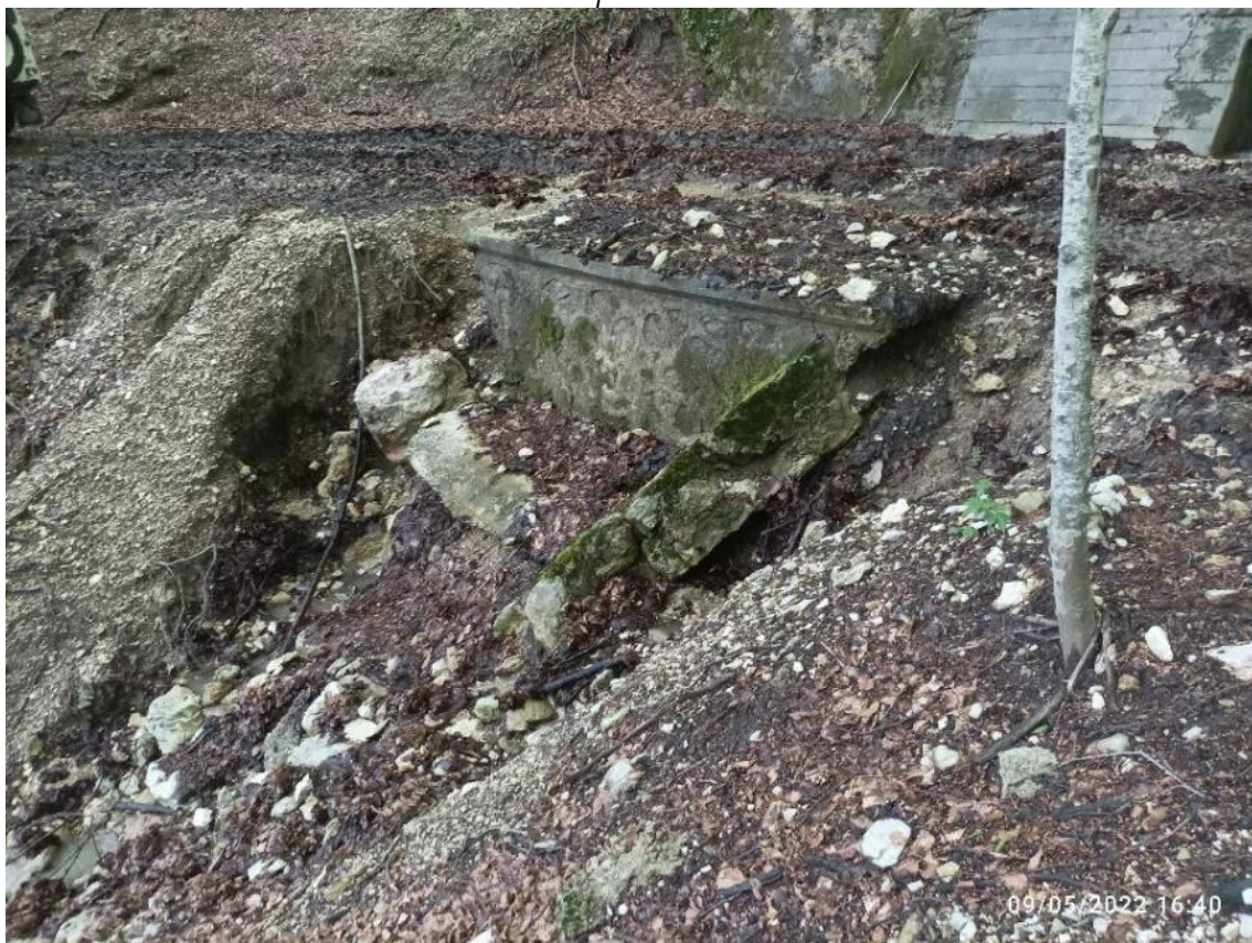
Foto 3 Soletta stradale: erosione laterale ed al piede
