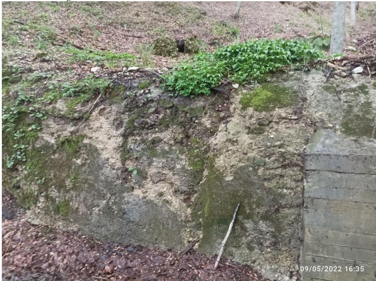
Foto 2 Canale di gronda: rivestimento eroso
