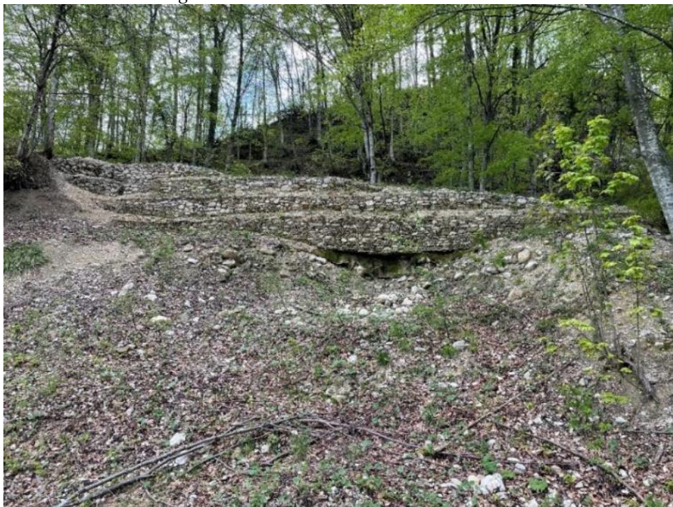
Foto 1 Gabbionata lungo la strada di accesso
