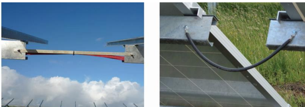
Figura 8 - Collegamento equipotenziale tra strutture adiacenti
