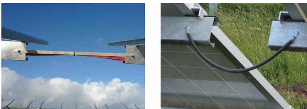
Figura 8: Collegamento equipotenziale tra strutture adiacenti
