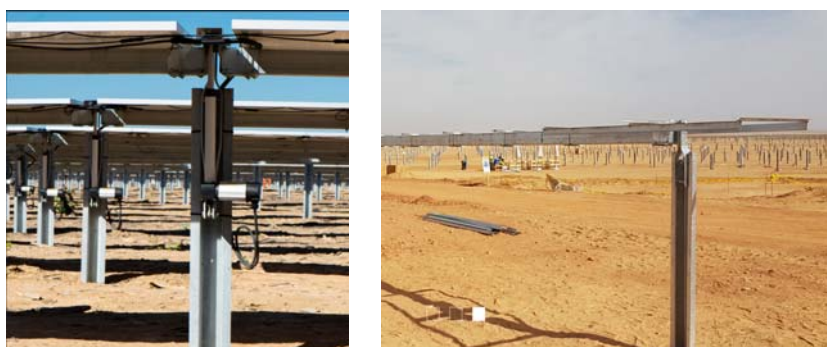
Figura 5a - Particolare strutture ad inseguimento ed attuatore
