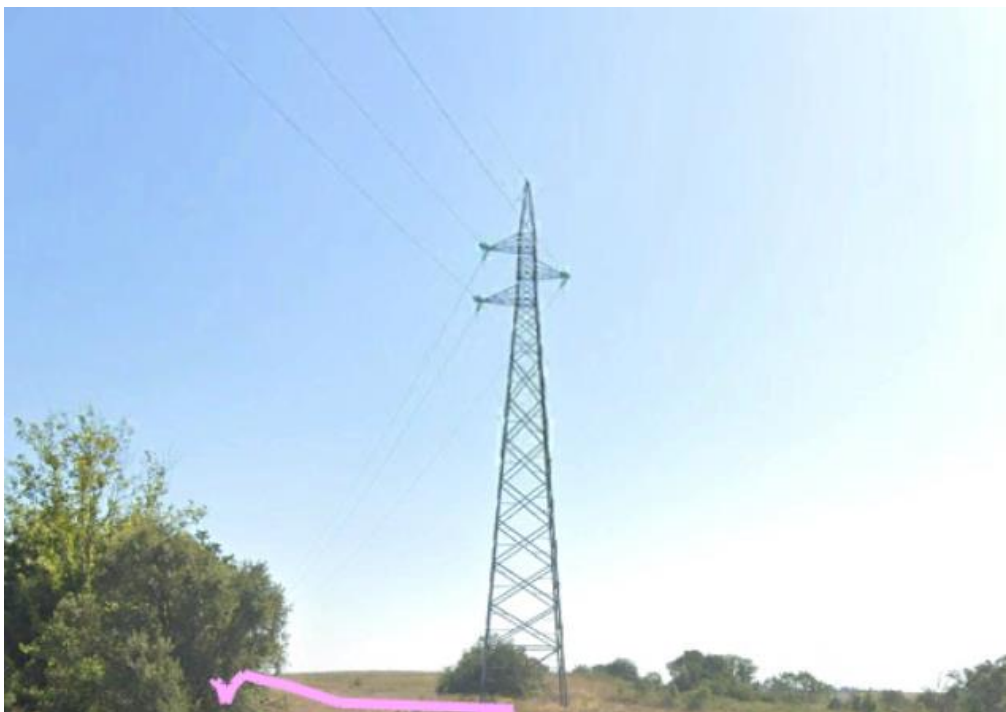
Figura 20 - Traliccio tronco piramidale linea AT da 150 kV Canino-Montalto
