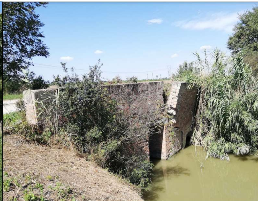
Ponte non idoneo lato nord
