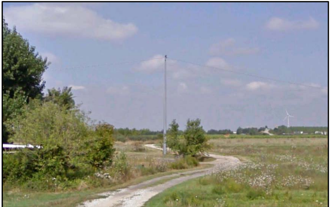
Figura 2.1d Esempio di Sostegno per Linea MT di Tipo Tubolare Monostelo in Cavo Unico Elicordato
