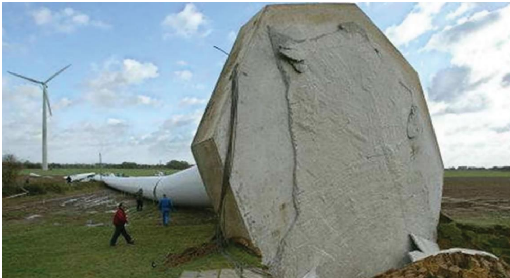
Figura 8- Ribaltamento della torre e del plinto
