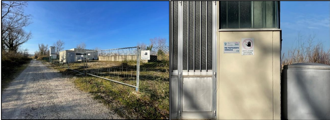
Foto n.1 – Documentazione fotografica dell'impianto Aset, di cui l'accesso è consentito solo al personale autorizzato da Via Papiria.
