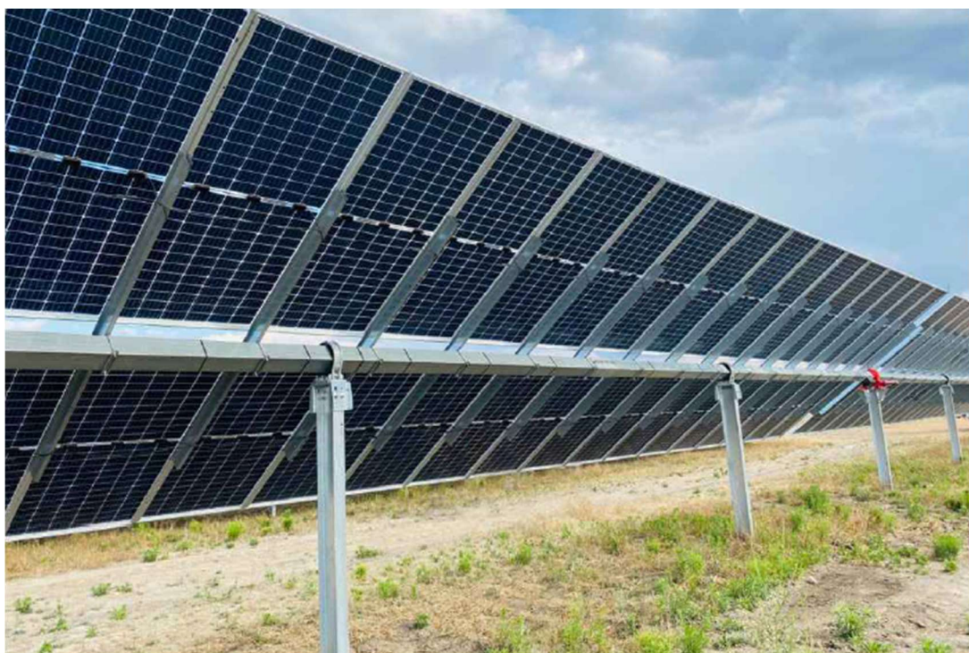
Figura 6 - Esempio di tracker monoassiale montante moduli bifacciali: si scorge in rosso il motore per l'inseguimento solare
