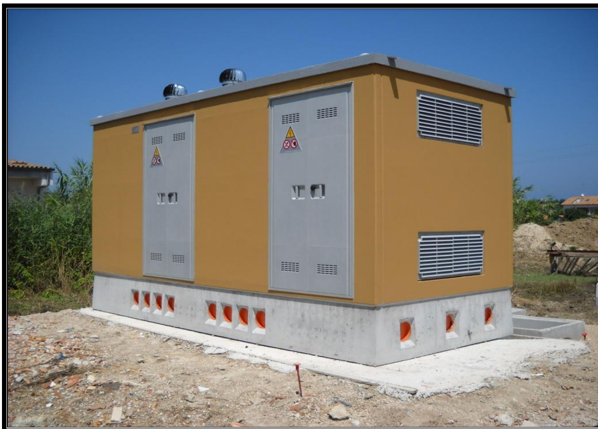
Figura 6 - ESEMPIO DI CABINA DI PARALLELO MT
