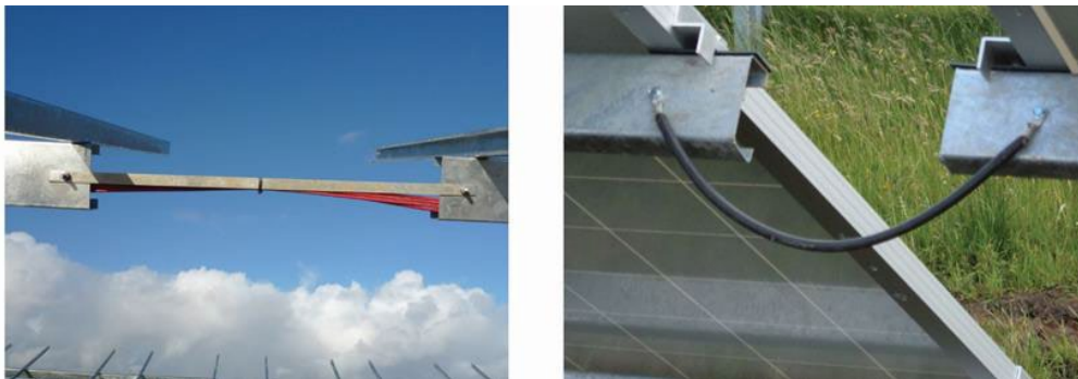
Figura 6: Collegamento equipotenziale tra strutture adiacenti
