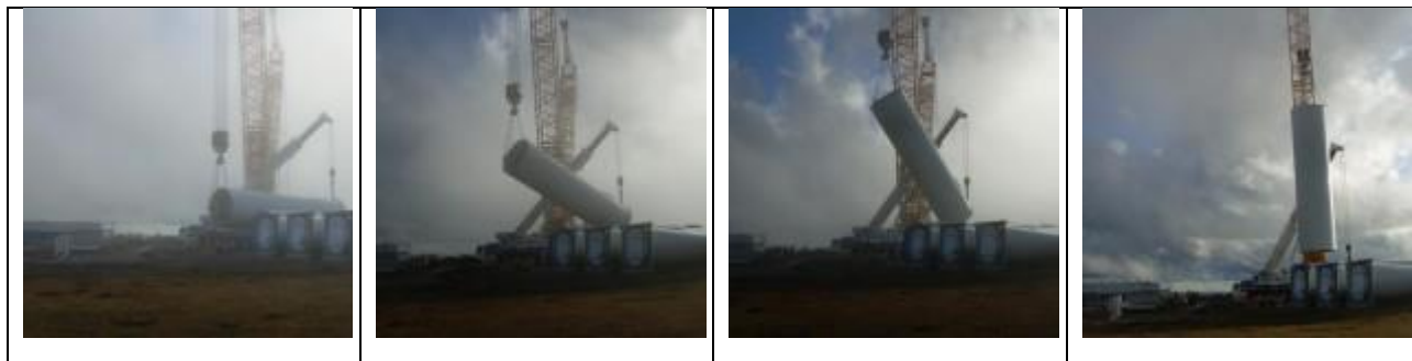
Figura 6.34 – Schema delle fasi di sollevamento dei componenti dell'aerogeneratore (Fonte sito web http://www.windfarmbop.com/ )
