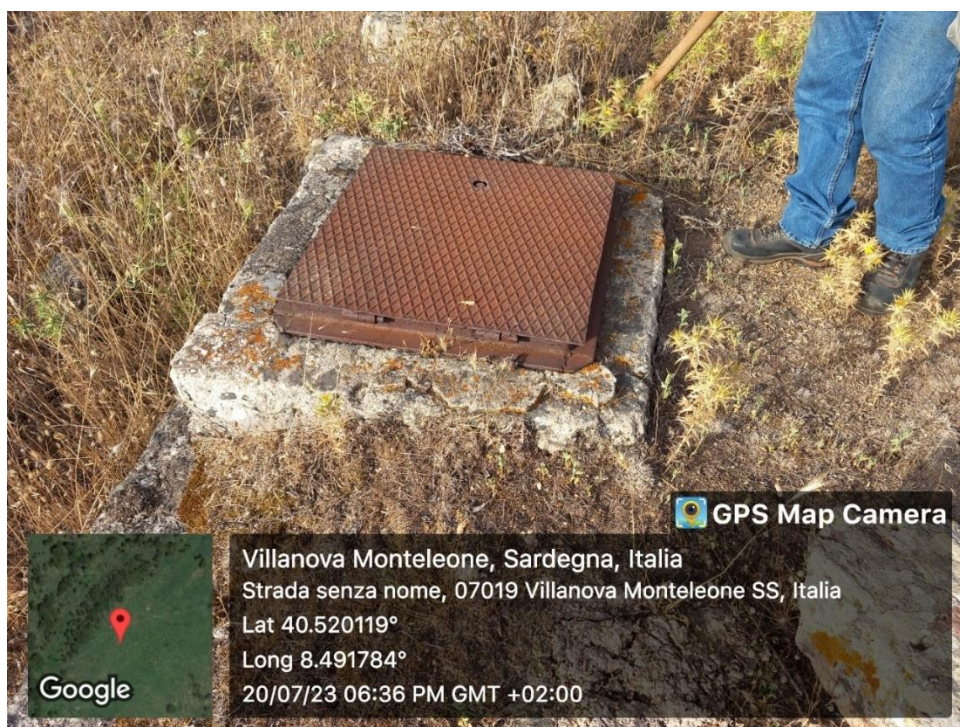
Figura 9.9 - Pozzetto situato nel tratto centrale della condotta idrica.
