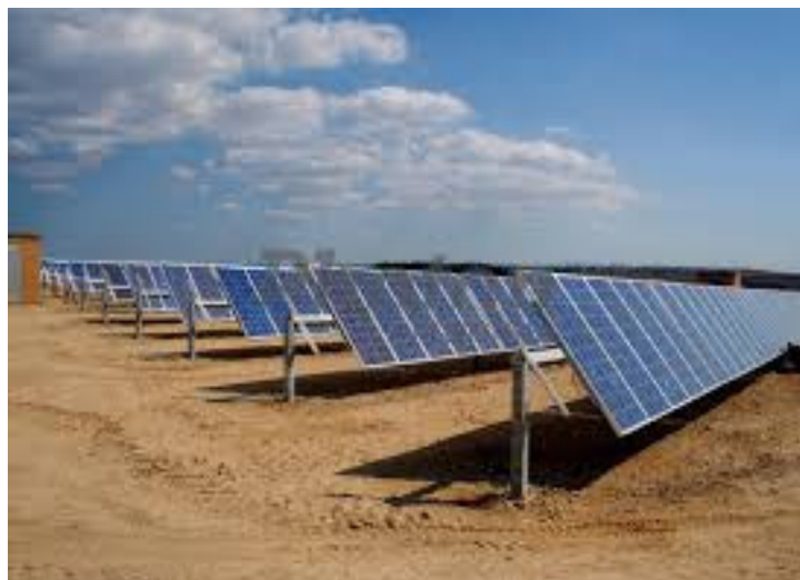
Figura 4 - Esempio di impianto fotovoltaico su struttura mobile
