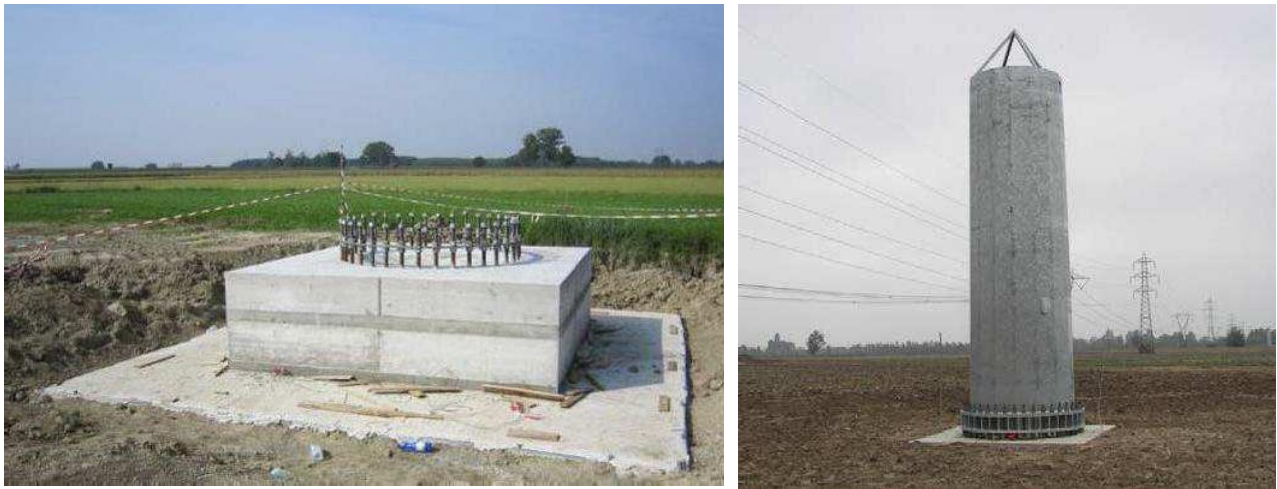
Figura 3 - Realizzazione di fondazioni superficiali tipo plinto a monoblocco per un sostegno monostelo. A sinistra si può osservare una fondazione appena realizzata, dove si può distinguere facilmente la flangia metallica dotata di tirafondi di raccordo con la parte in elevazione. A destra è riportato un esempio di fondazione completata e la sistemazione del terreno nell'area circostante
