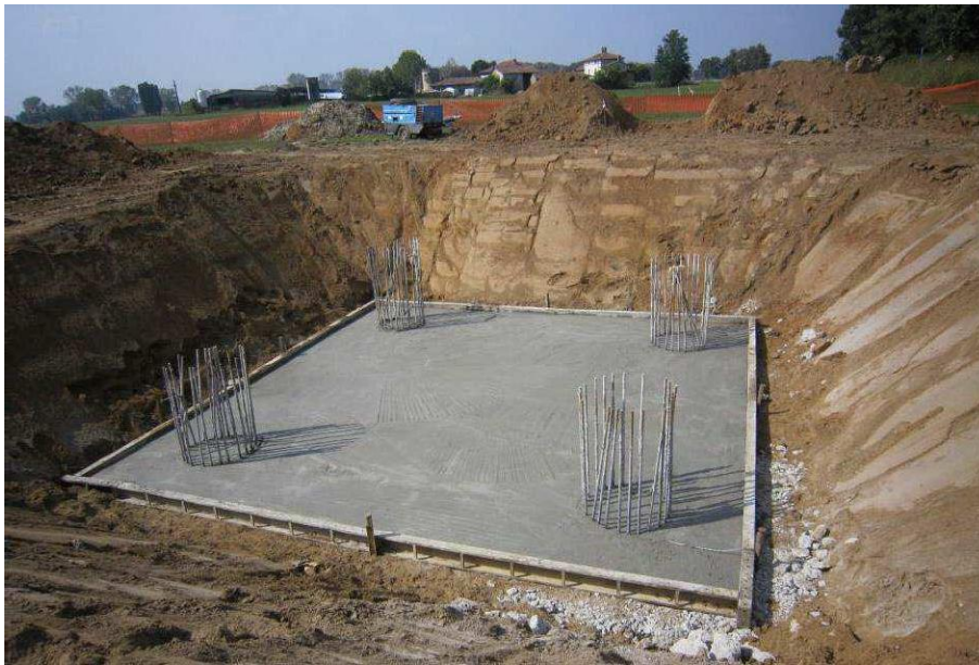
Figura 5 - Realizzazione di una fondazione su pali trivellati per un sostegno monostelo. Nell'immagine si può osservare una fondazione in fase di realizzazione. Si possono distinguere facilmente i quattro pali trivellati già realizzati e gettati (si osservano le "riprese" delle quattro gabbie metalliche) ed il piano di "magrone" sul quale impostare il monoblocco in cls
