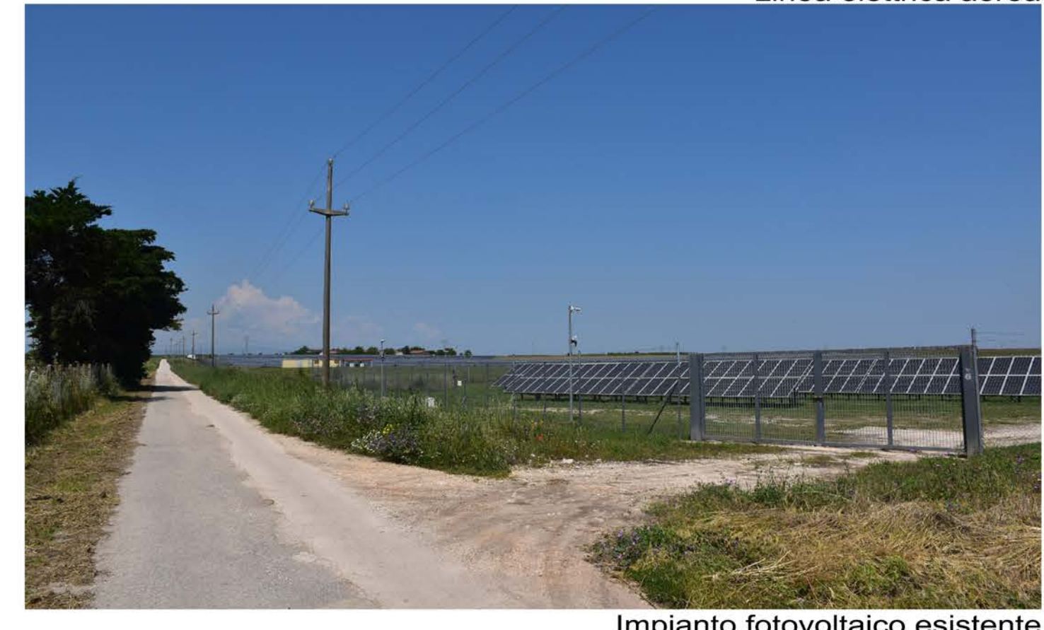
Impianto fotovoltaico esistente
