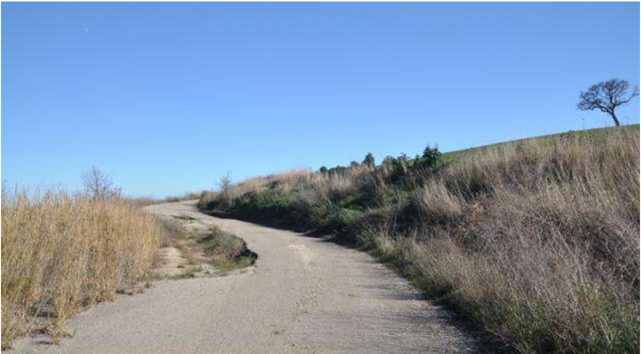
Figura 20: strada del consorzio di bonifica chiusa al traffico
