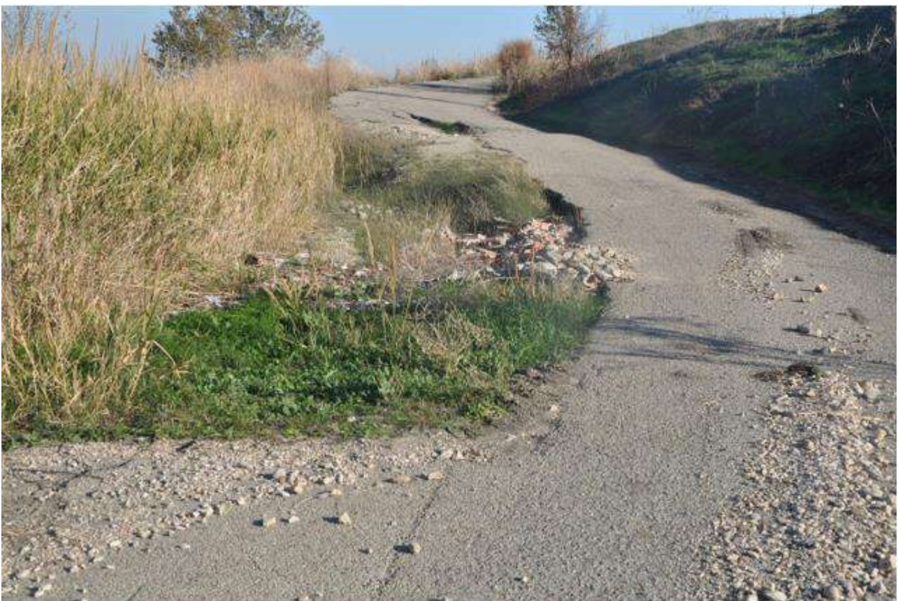
Strada sconnessa del Consorzio di Bonifica Trigno e Biferno chiusa al traffico – Cono A (nessun campo si vede)
