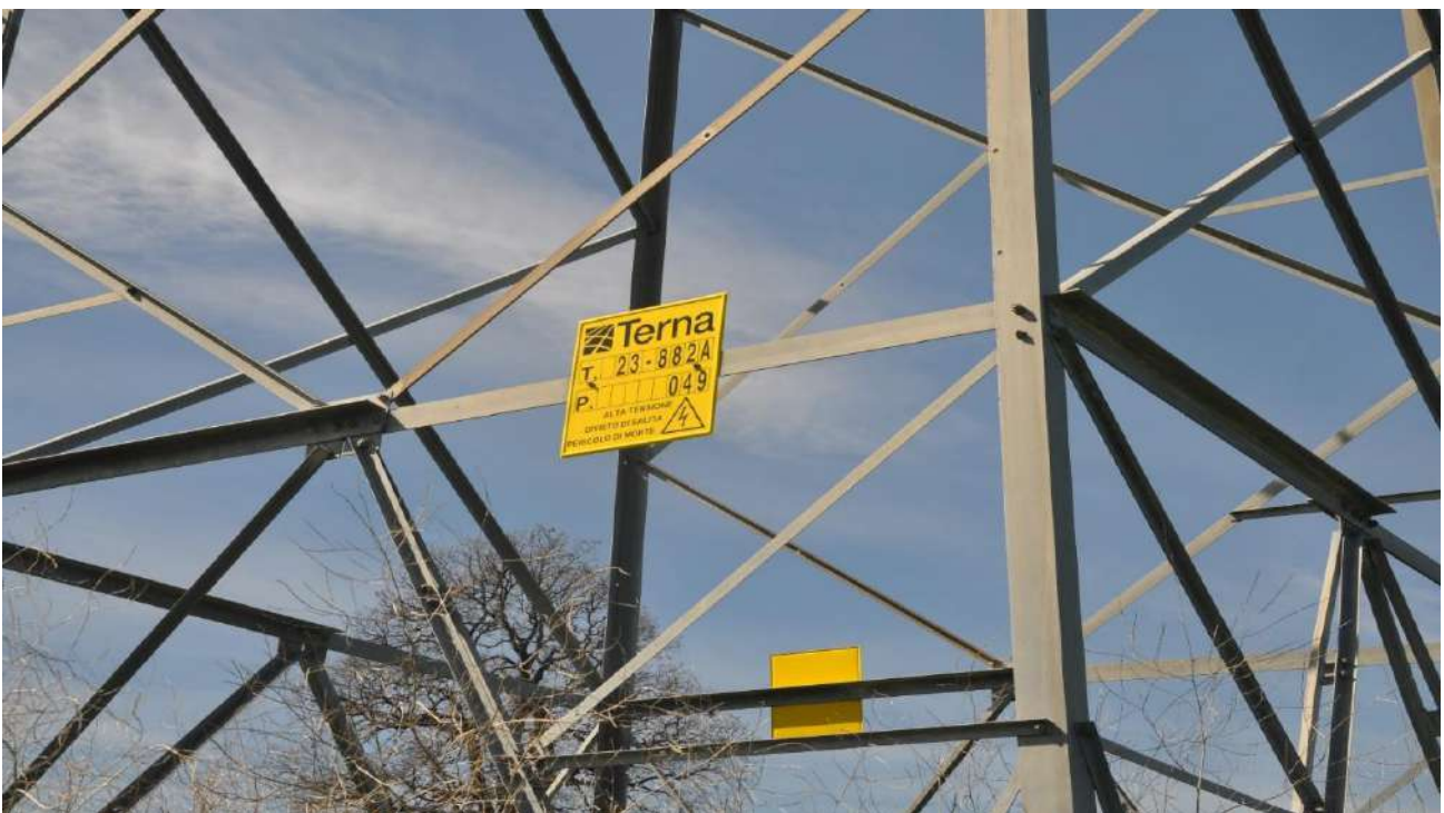
Figura 23 Traliccio della linea elettrica ad alta tensione di Terna che attraversa il sito
