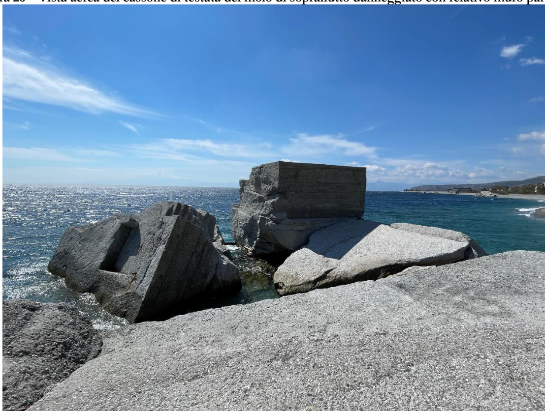
Figura 27 – Molo di sopraflutto. Cassone di testata danneggiato, con relativo muro paraonde.
