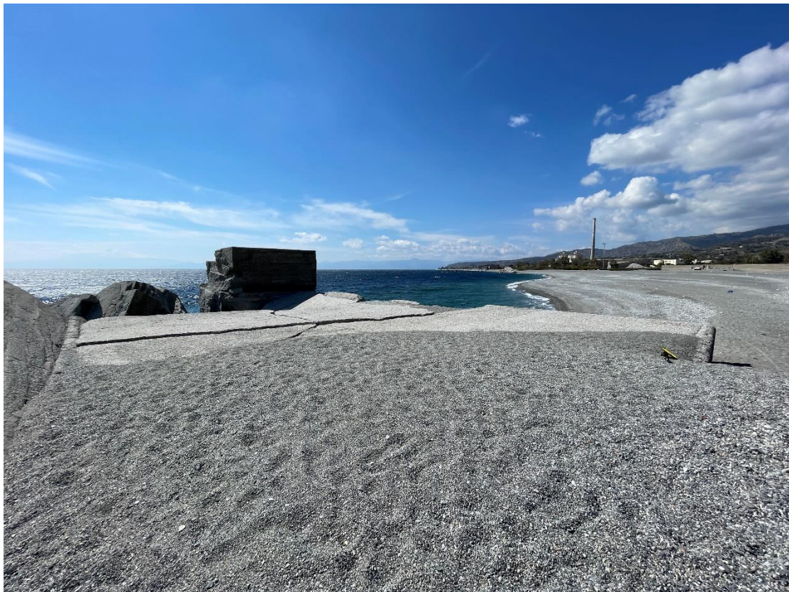
Figura 29 – Cassone e muro paraonde della testata del molo di sopraflutto danneggiati
