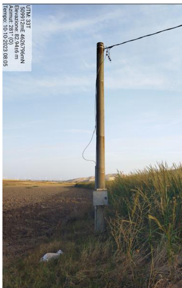
Figura 46 - Interferenza con linea telefonica nei pressi della torre uno
