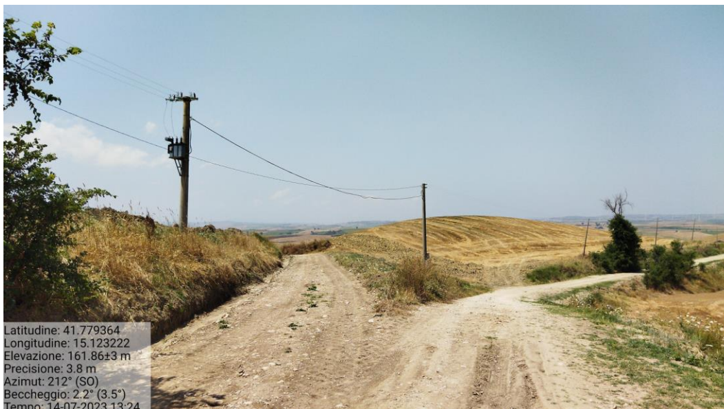
Figura 66 - Punto di congiunzione delle linee aeree MT e BT - Punto di scatto 88
