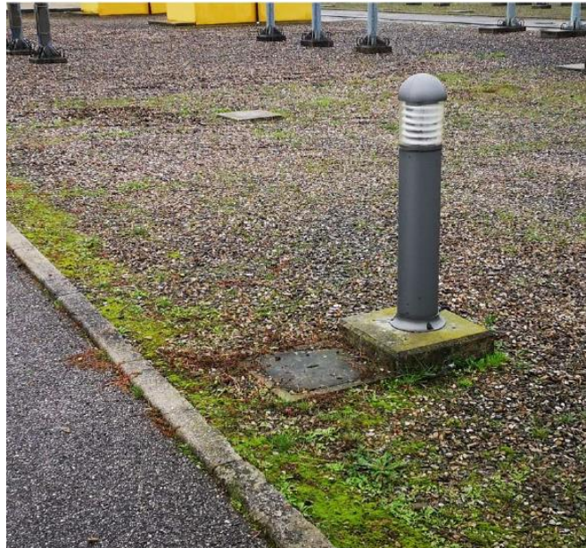
Figura 8: Esempio di palina di illuminazione.
