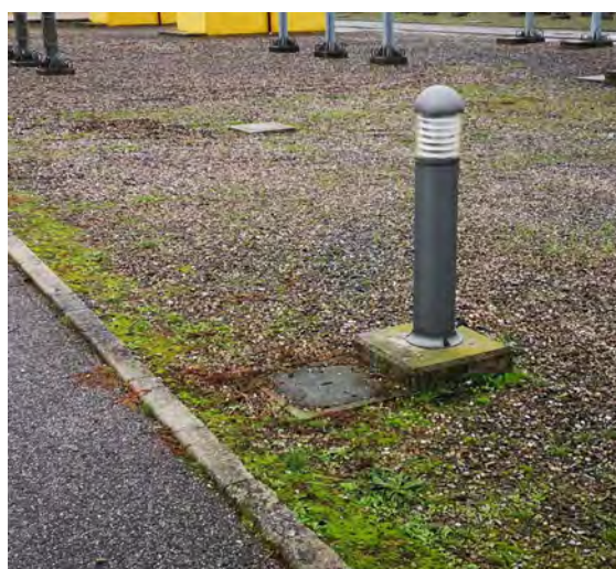
Figura 15: Esempio di palina di illuminazione
