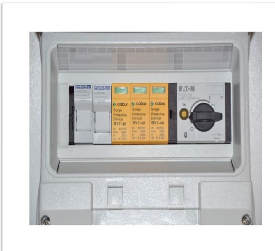
Figura 4: tipico quadro di parallelo stringhe
