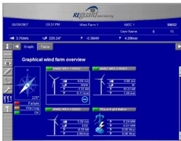
SCADA – Visualizzazione Stato del Parco Eolico.
