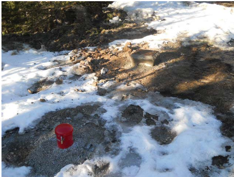
Pozzetto a capitello su S02bis e carrabile su S02
