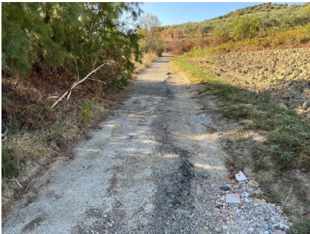
Foto 34: PV34 – Tratto di strada asfaltata dissestata interessato dal passaggio del cavidotto. (Coordinate: N39°41'11.87"; E16°20'38.34" m N)
