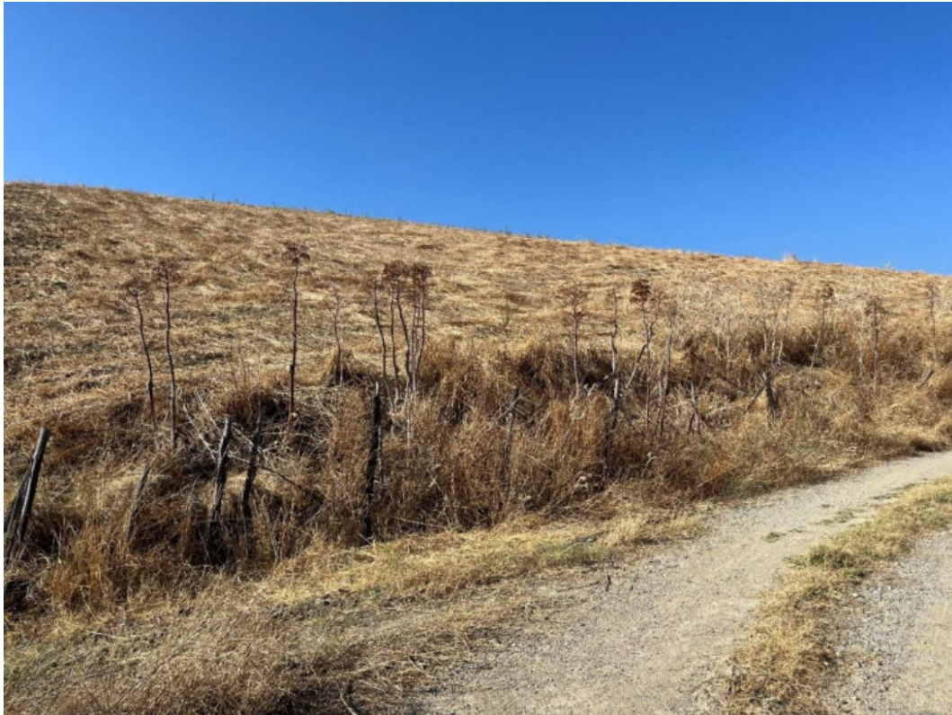
Foto 54: PV54 – Passaggio del cavidotto interessato dalla presenza di terreno incolto. (Coordinate: N39°40'36.23"; E16°21'7.84" m N)
