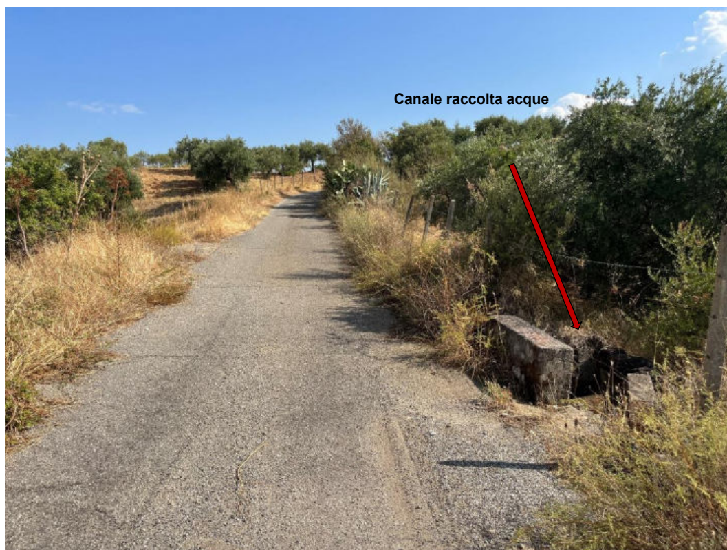
Foto 21: PV21 – Tratto di strada asfaltata interessato dal passaggio del cavidotto con interferenza canale raccolta acque. (Coordinate: N39°41'56.90"; E16°20'19.30" m N)
