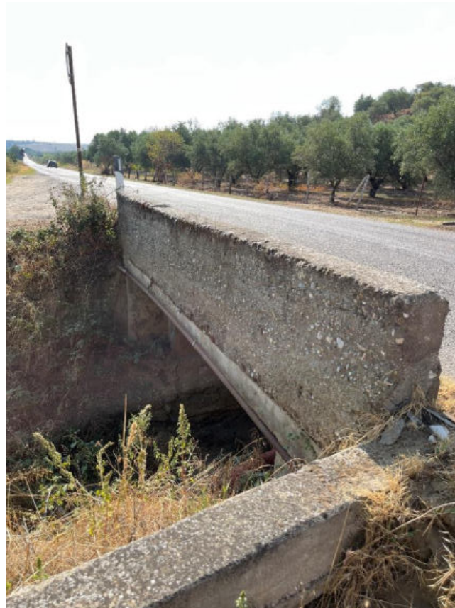
Foto 10: PV10 - Passaggio del cavidotto in fiancheggiamento al ponte esistente. (Coordinate: N39°42'38.26"; E16°19'50.88" m N)
