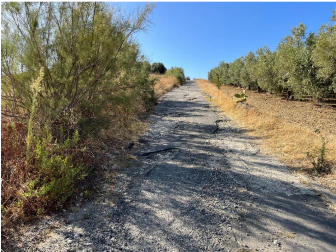
Foto 39: PV39 – Tratto di strada asfaltata dissestata interessato dal passaggio del cavidotto. (Coordinate: N39°40'33.58"; E16°20'27.15"m N)
