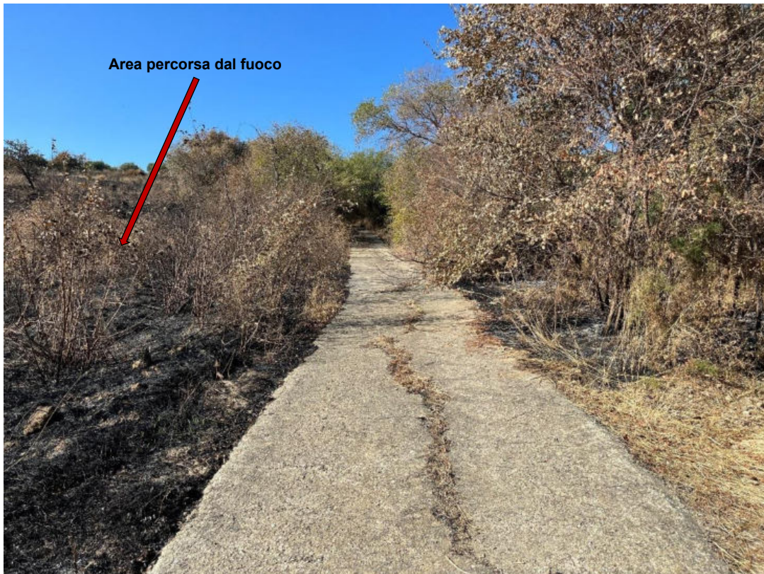
Foto 36: PV36 - Tratto di strada asfaltata con area percorsa dal fuoco bordo strada. (Coordinate: N39°40'47.22"; E16°20'31.05" m N)
