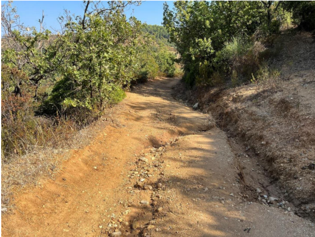
Foto 100: PV100 - Tratto di strada dissestata interessato dal passaggio del cavitotto. (Coordinate: N39°35'49.56"; E16°19'41.16" m N)
