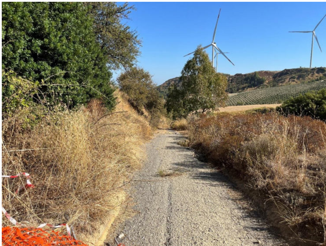
Foto 38: PV38 - Tratto di strada bianca interessato dal passaggio del cavidotto. (Coordinate: N39°37'22.01"; E16°21'45.28" m N)
