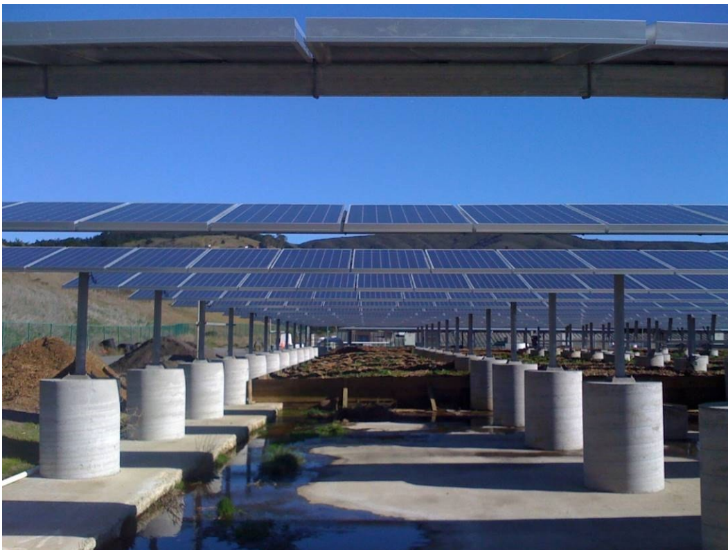
Figura 11: Esempio di impianto fotovoltaico con fondazioni formate da zavorre costituite da plinti in cemento.
