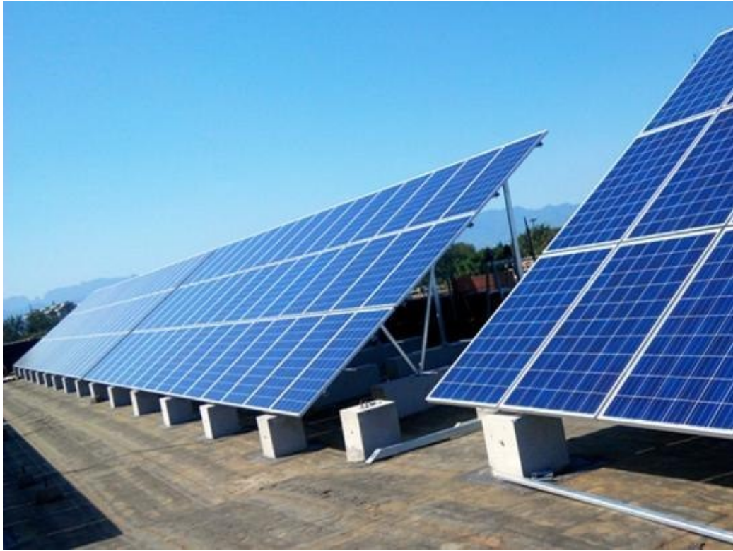
Figura 12: Esempio di impianto fotovoltaico con fondazioni formate da zavorre costituite da plinti in cemento.
