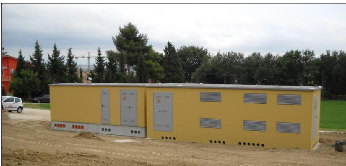
CABINA DI CAMPO TIPO a
