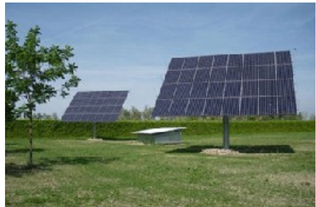
Foto 9 - Impianto fotovoltaico con pannelli ad inseguimento
