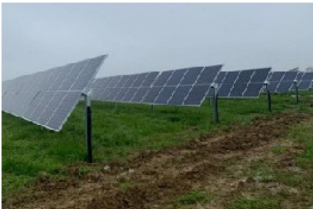
Foto 8 - Impianto fotovoltaico con pannelli ad inseguimento
