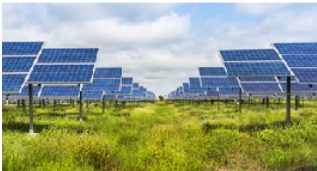
Foto 10- Impianto fotovoltaico con pannelli ad inseguimento
