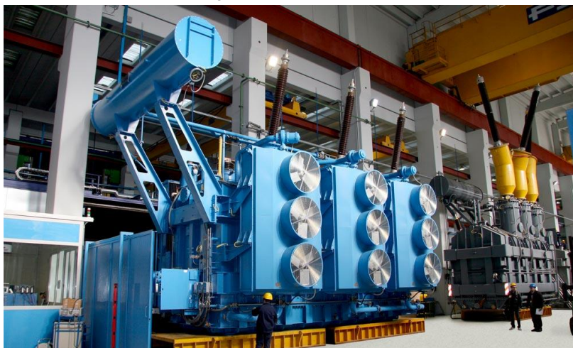
Figura 7:25 Esempio di trasformatore 220 kV/380 kV [Fonte: Getra Group]
