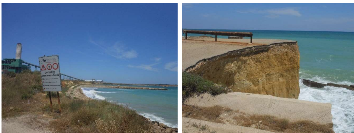
Figura 4.3: Indicazione di Pericolo smottamento falesia e crollo della sede stradale costiera in corrispondenza dell'approdo del caido
