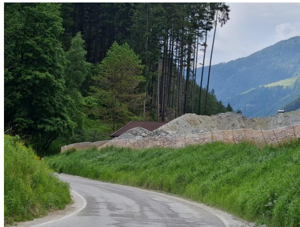
Blick auf die Materialhaufen entlang des Radweges Vista dei cumuli di materiale percorrendo la pista ciclabile
