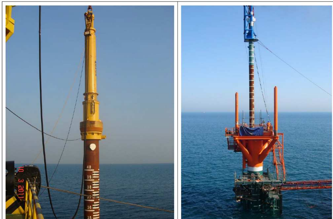
Figura 3-36: battipalo per infissione dei pali di fondazione (immagine a sinistra) e fase di battitura tubi guida
