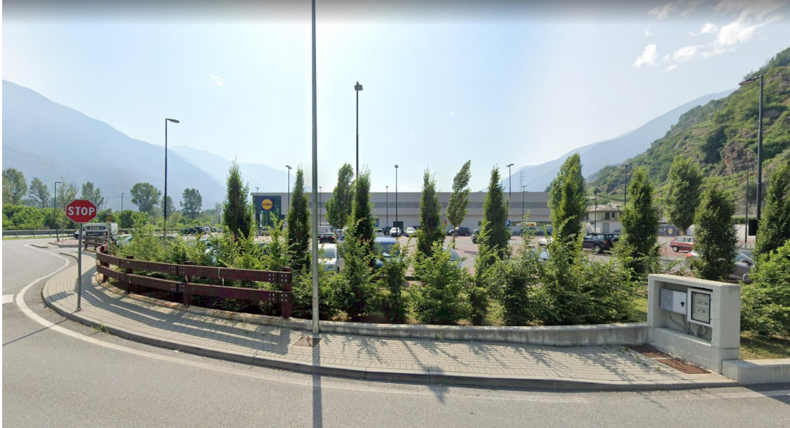
Figura 1: Quadro di comando ed impianto illuminazione pubblica
